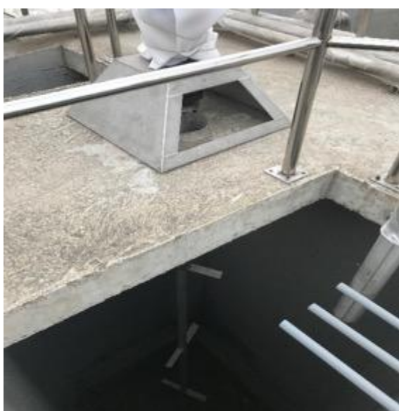
Bể keo tụ
