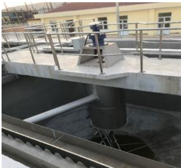
Bể lắng sinh học
