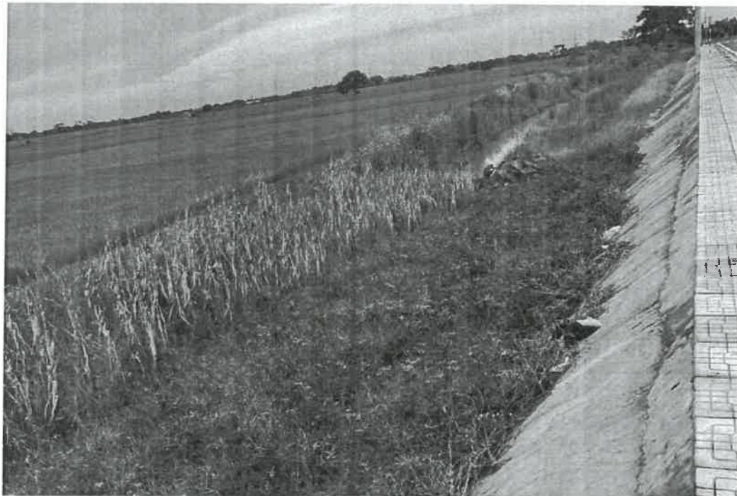
Hình 14. Hiện trạng cote nền dự án thấp hơn cote nền đường hiện trạng
