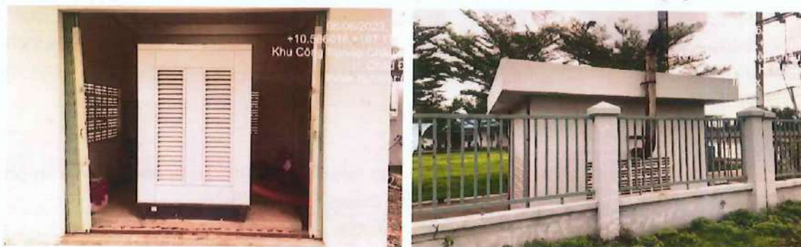
Máy phát điện công suất 500KVA
