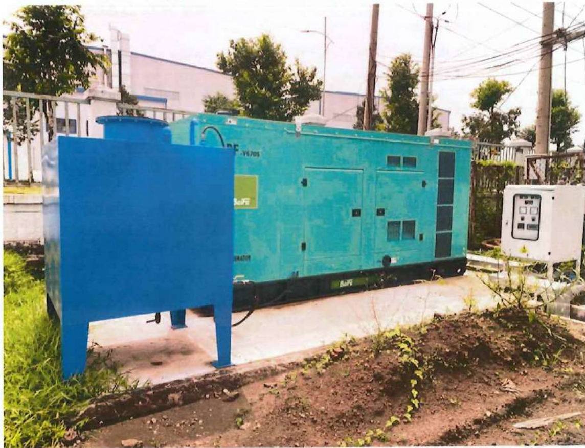
Hình 3. 29. Hình ảnh máy phát điện dự phòng công suất 650 KVA lắp mới của cơ sở
