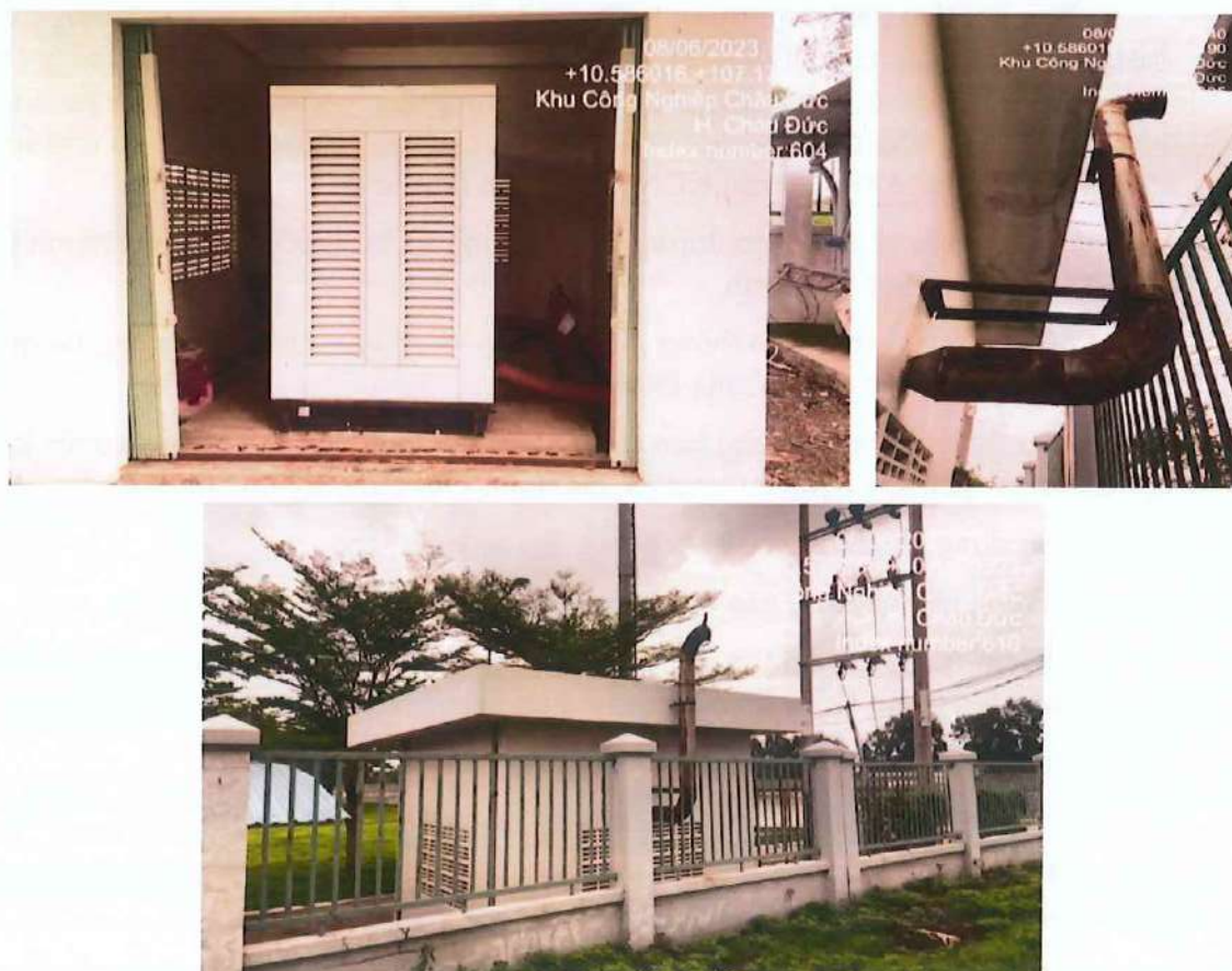
Hình 3. 28. Một số hình ảnh máy phát điện dự phòng công suất 500KVA của cơ sở
