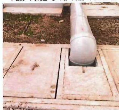
Đường ống dẫn nước thải đầu vào về mương dẫn M2
