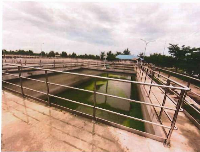
Hình 3. 14. Bể điều hòa
