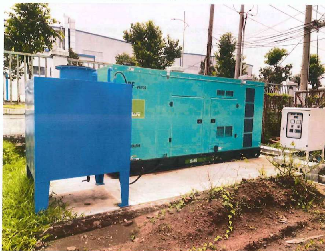
Máy phát điện công suất 650KVA
