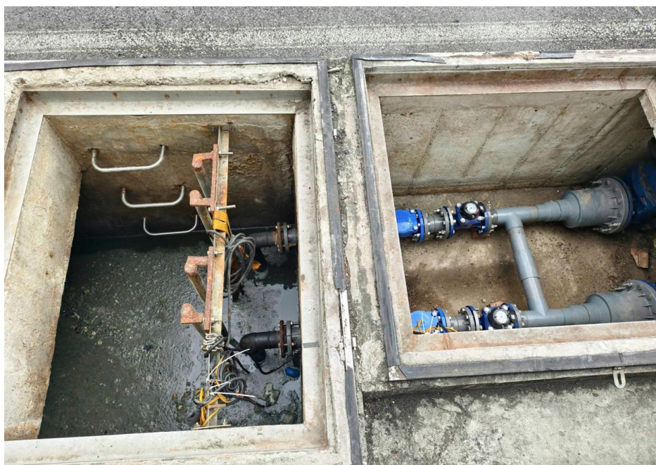
Hình 12: Bơm chuyển nước thải tại hố bơm TB3
