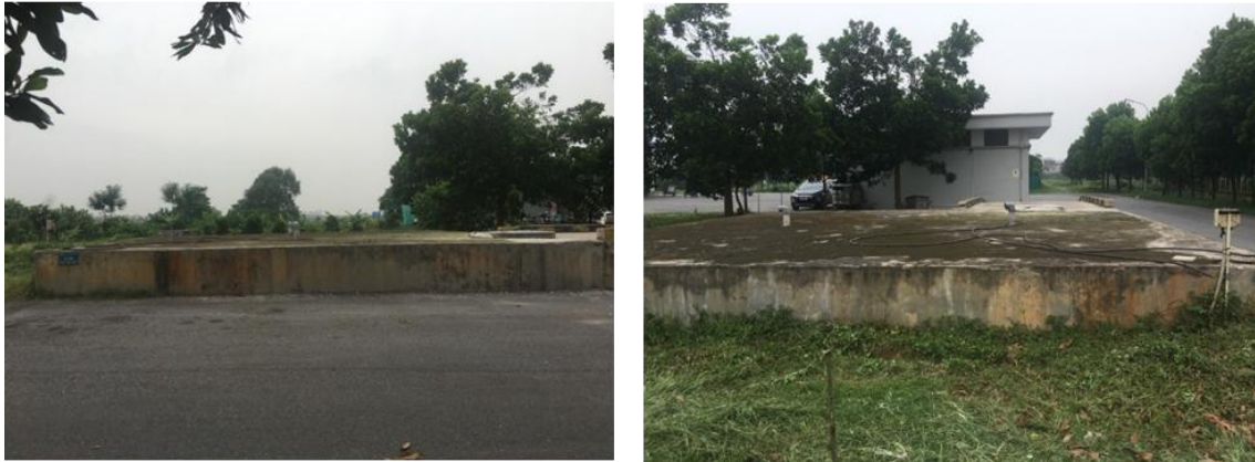
Hình 23: Bể chứa chất thải lỏng, phân bùn bể phốt
