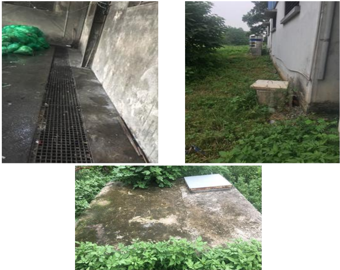
Hình 22: Rãnh thu, hố thu và bể chứa nước rửa sàn nhà chứa chất thải rắn thông thường tại Trạm trung chuyển chất thải Nội Bài
