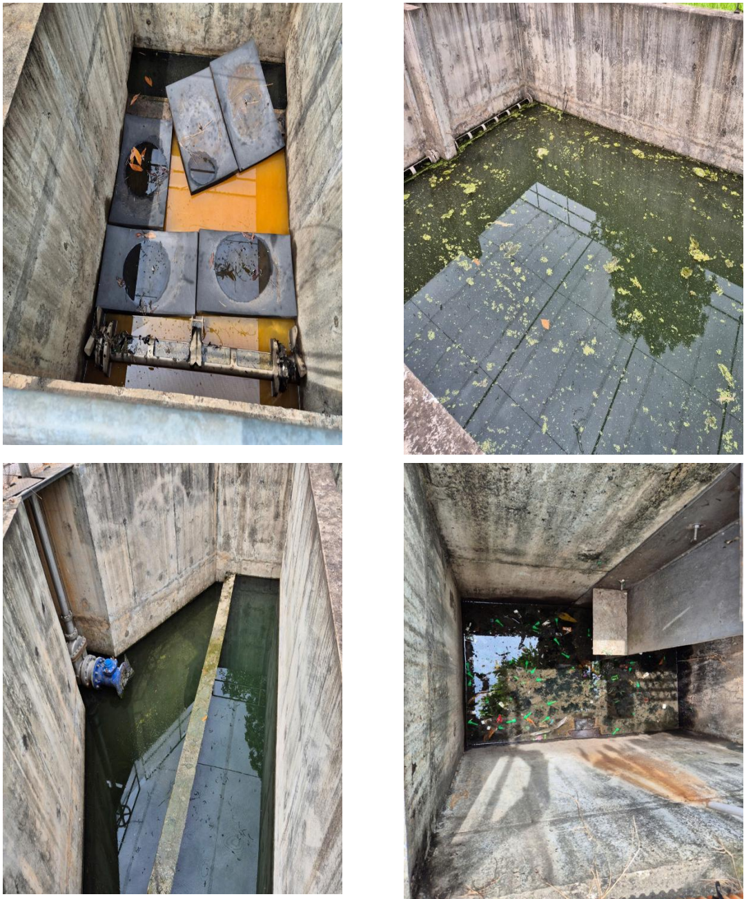
Hình 15: Hệ thống xử lý nước thải của Kho xăng dầu NAFSC
