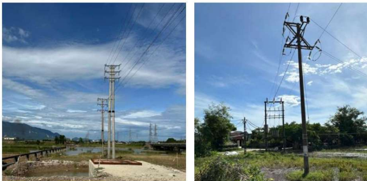
Hình 1. 5. Tuyến đường dây 35kV và Trạm biến áp
