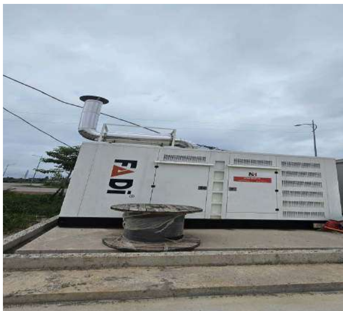
Hình 3.15. Máy phát điện dự phòng của giai đoạn 01
