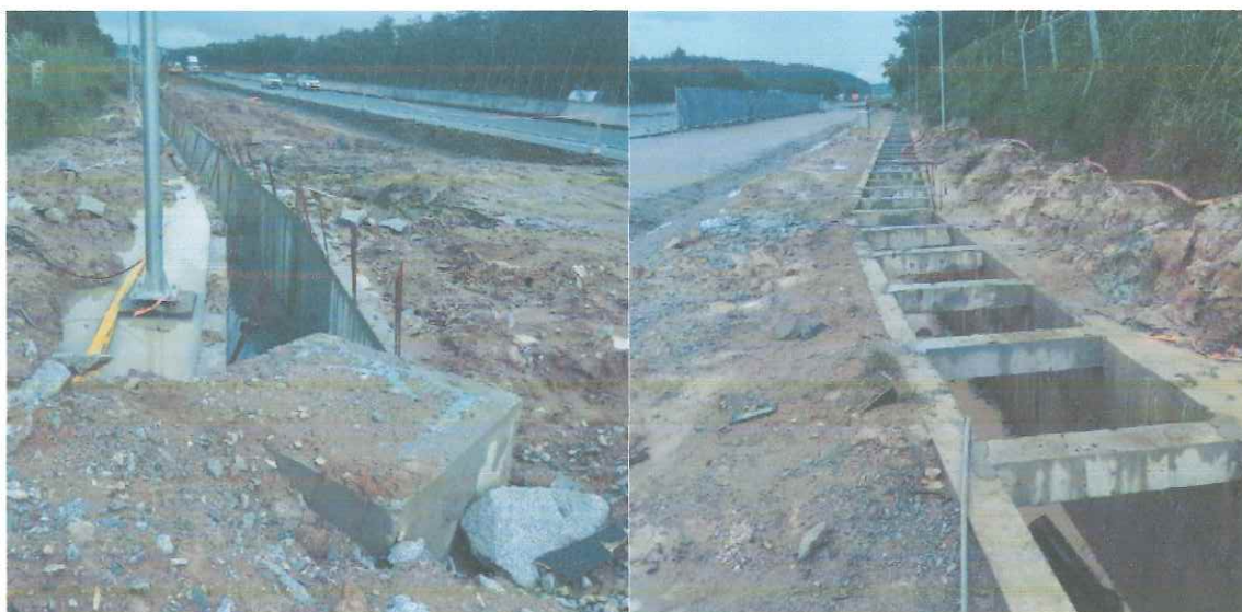
Hình 3. 21. Hình ảnh hệ thống thoát nước ra suối Km47+101,8
