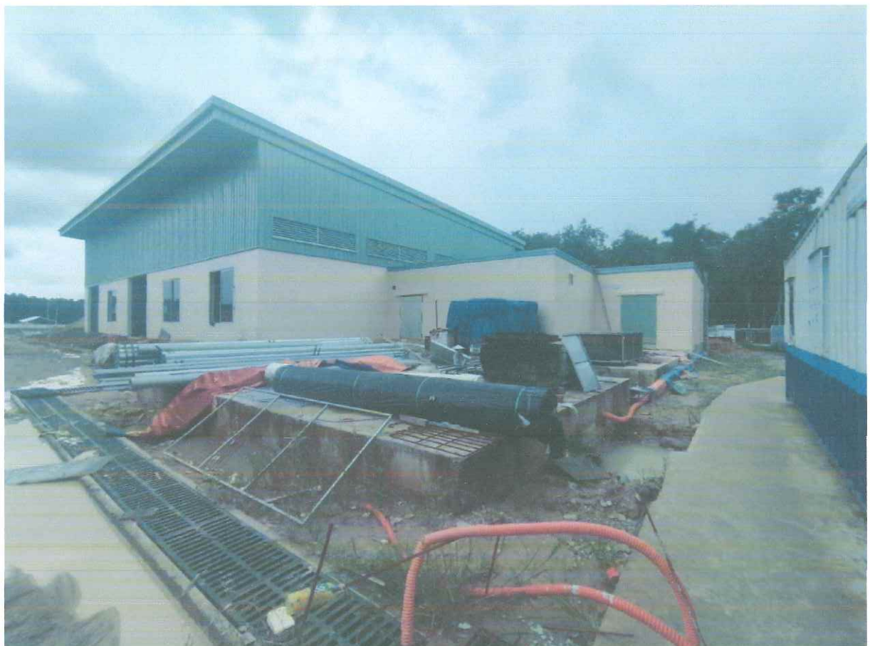
Hình 3. 37. Hệ thống xử lý nước thải rửa xe số 1
