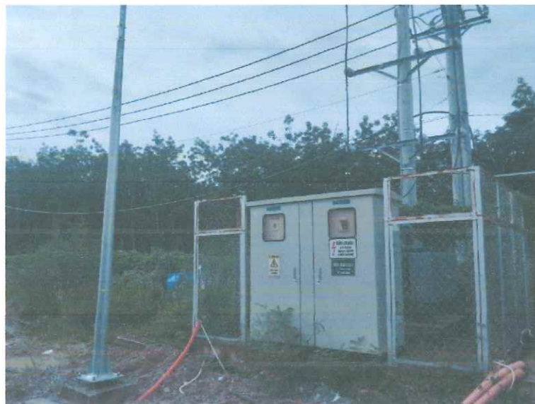
Hình 1. 18. Hình ảnh trạm biến áp của dự án
