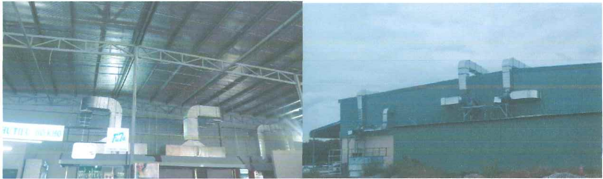
Hình 3. 40. Hiện trạng hút mùi bếp trạm 2
