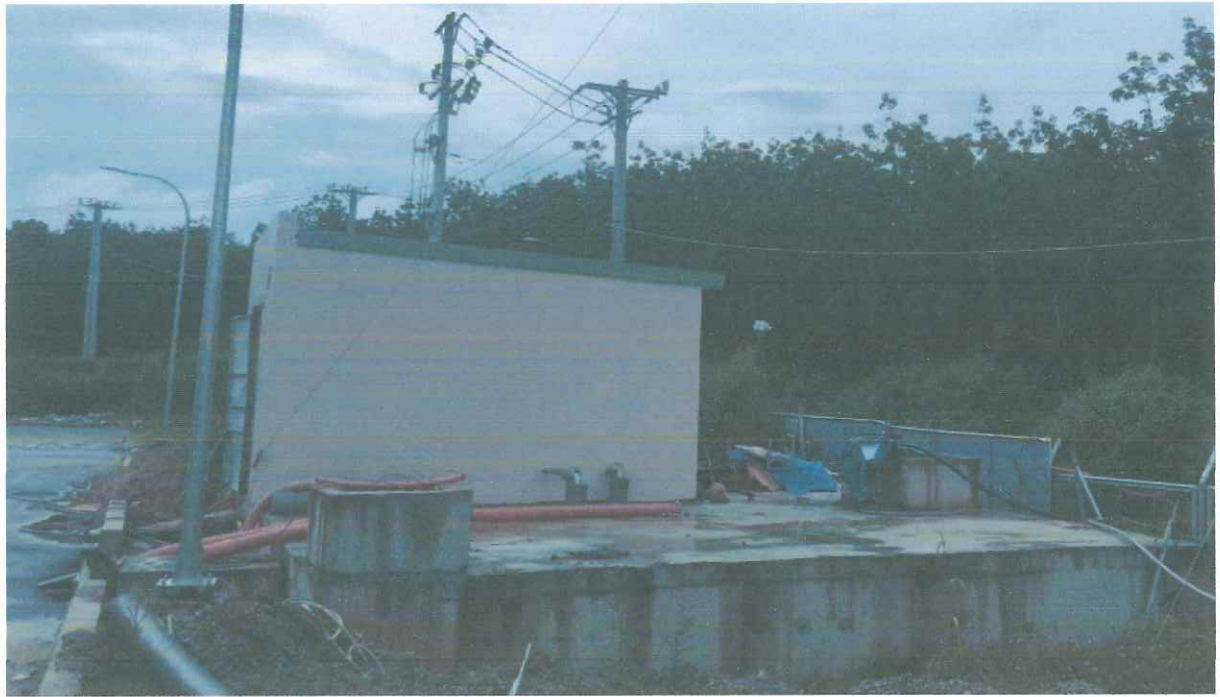
Hình 3. 38. Hệ thống xử lý nước thải rửa xe số 2
