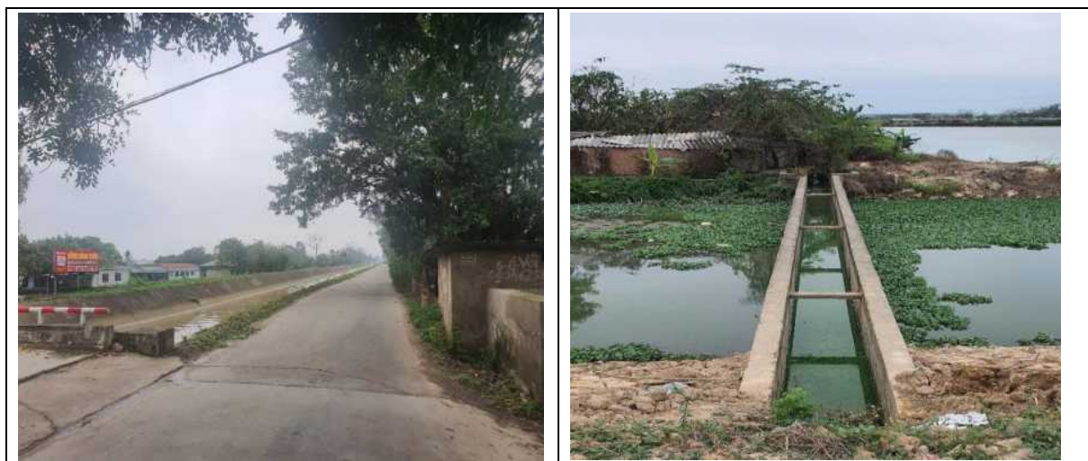
Hình 1.4. Hiện trạng kênh mương trong khu vực Dự án
