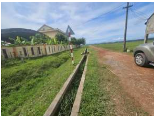
Hình ảnh mương cấp nước
