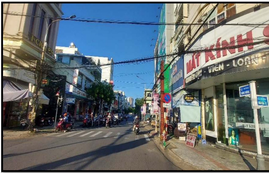
Hình 9: Tuyến chiếu sáng đi nổi đèn Led
