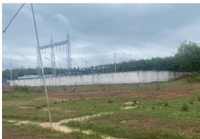
Hình 1.6. Hiện trạng Trạm biến áp TBA Hoa Lư
