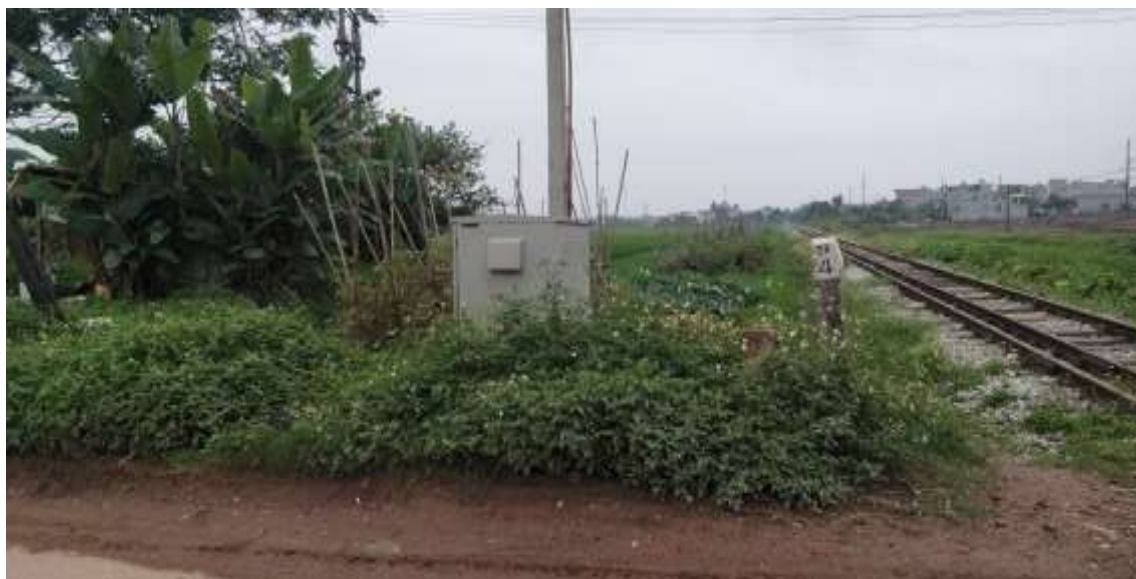
Trạm điện 35Kv nằm ở phía Nam ngoài ranh giới lập quy hoạch
