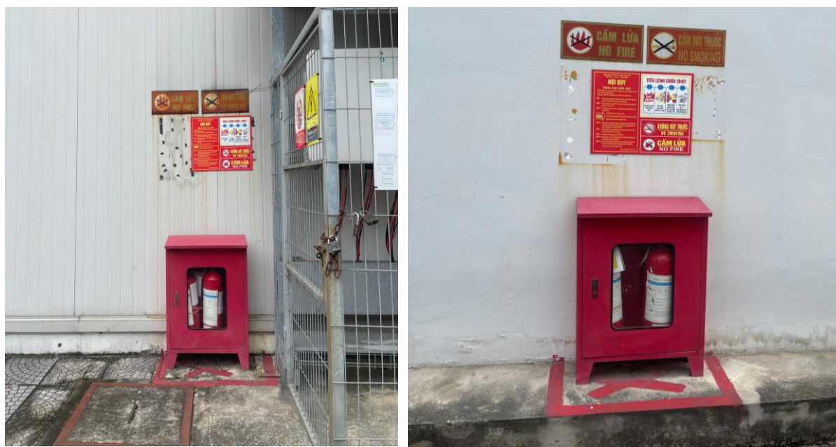
Hình 3. 18. Dụng cụ PCCC tại Cơ sở
