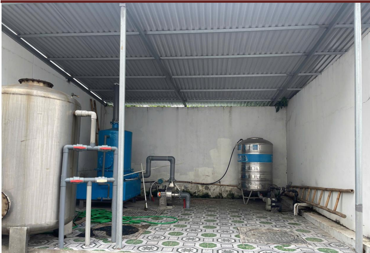
Hình 3. 10. Khu vực hệ thống xử lý nước thải tập trung công suất 70m 3 /ngày.đêm
