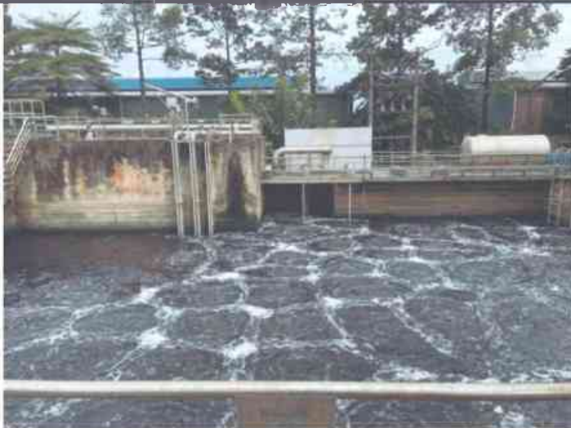
Hình 3.12. Bể điều hòa (Bể cân bằng) của trạm xử lý nước thải
