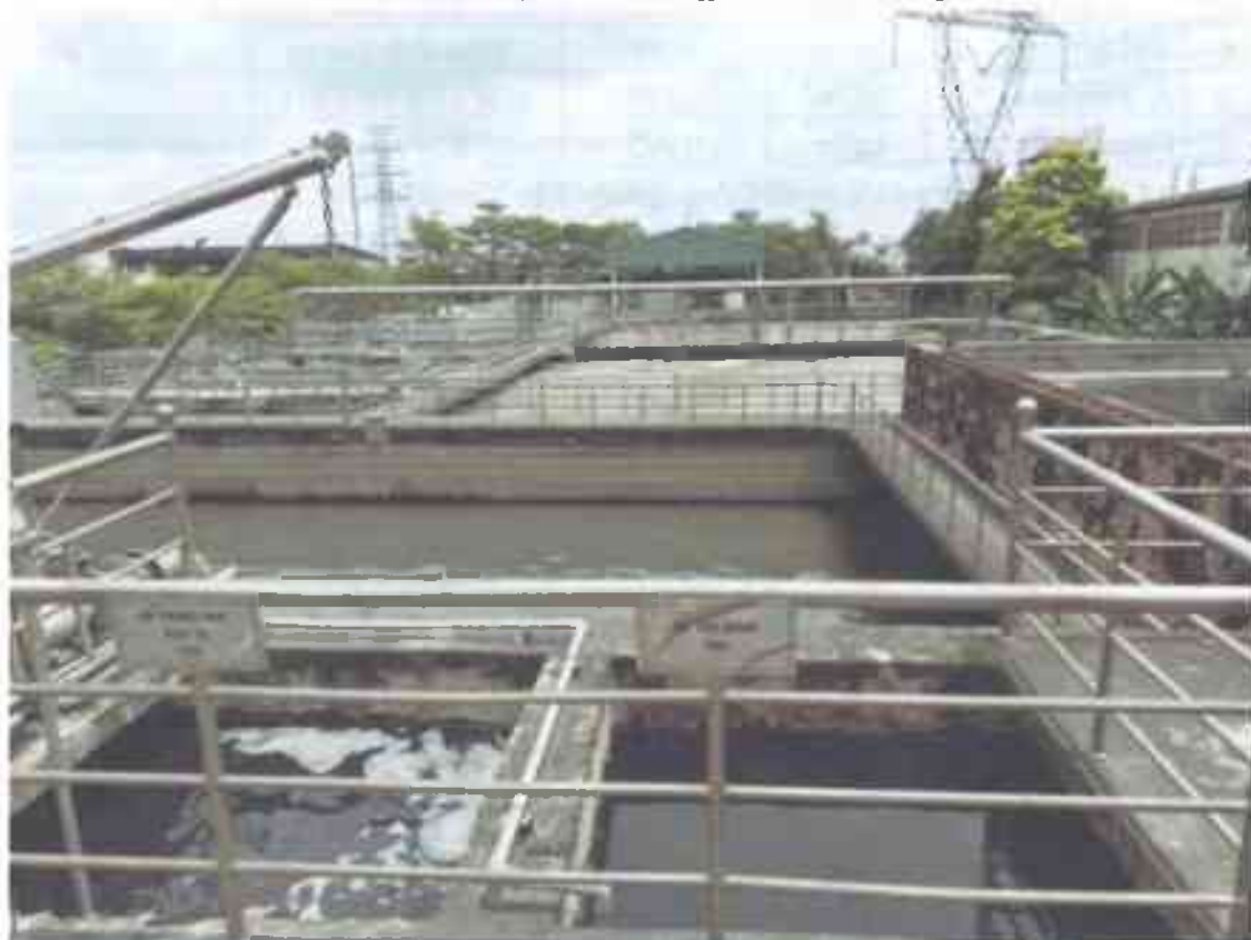
Hình 3.13. Cụm bể hóa lý của trạm xử lý nước thải
