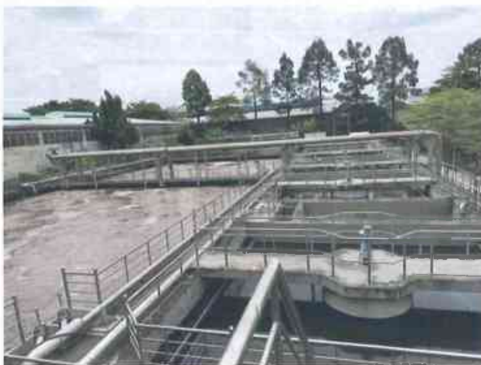
Hình 3.11. Hình ảnh tổng thể trạm xử lý nước thải tập trung KCN
