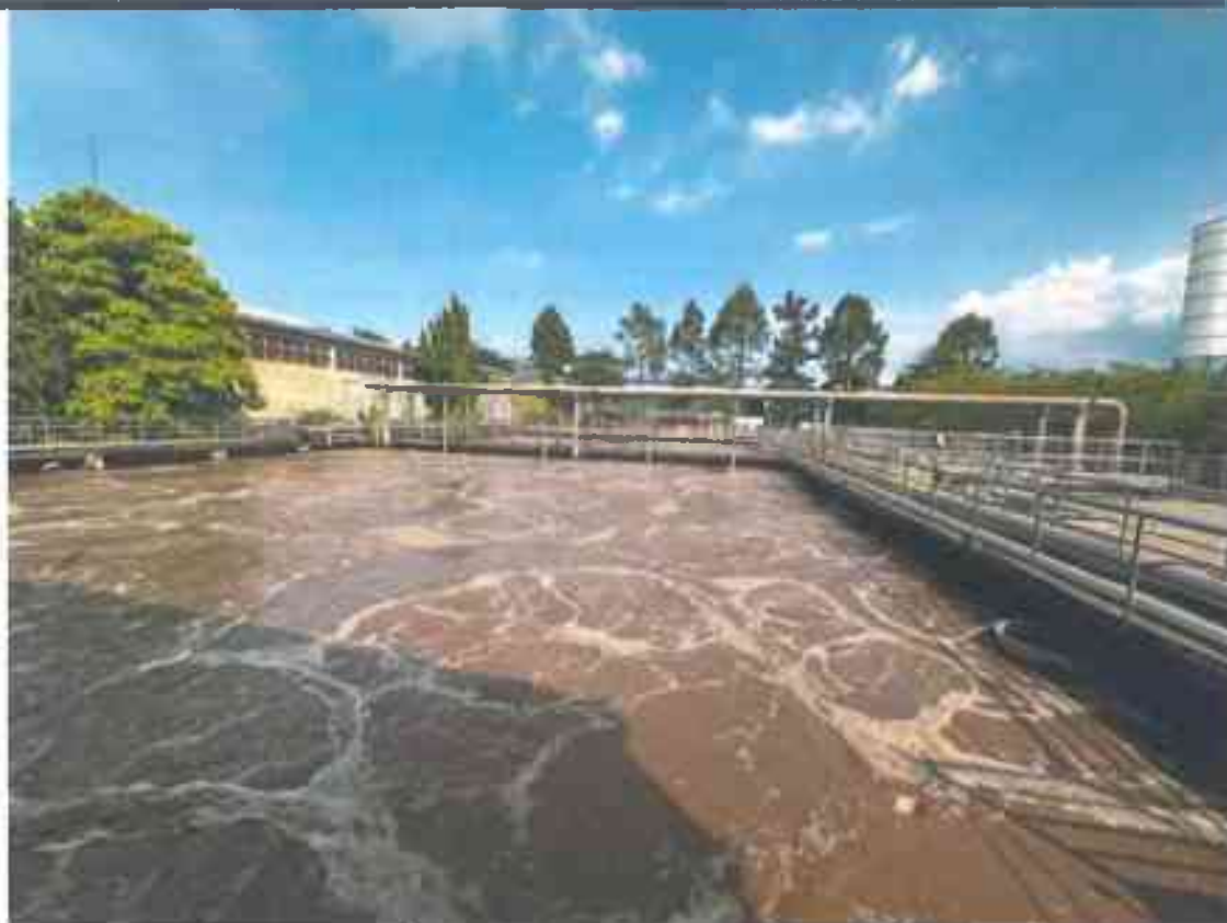
Hình 3.14. Bể sinh học hiếu khí của trạm xử lý nước thải
