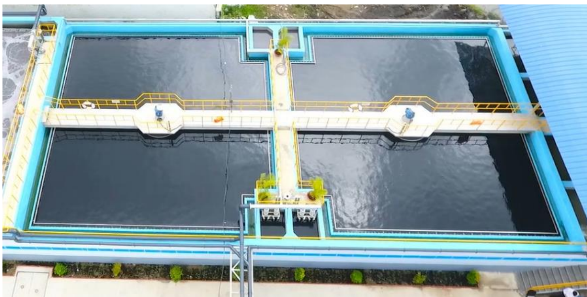
Hình 2.9. Bể lắng sinh học
