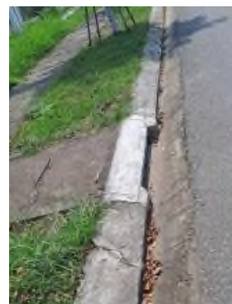
Hố ga thu nước mưa bề mặt
