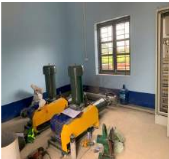
Hệ thống máy bơm
