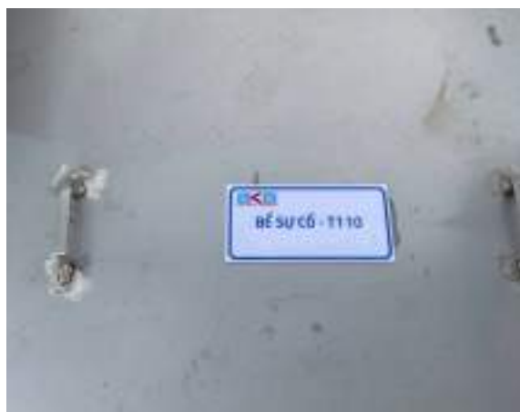
Bể sự cố
