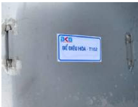
Bể điều hòa
