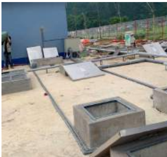
Khu vực các bể xử lý nước thải
