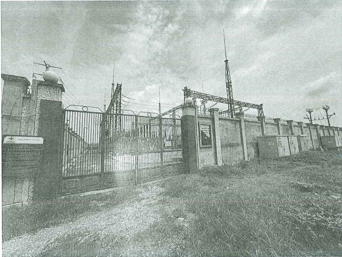
Trạm biến áp 110KV
