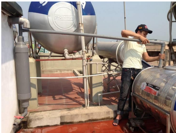
Thu gom nước mưa trên mái nhà
