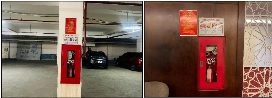
Hình 3.11. Một số hình ảnh về PCCC tại cơ sở
