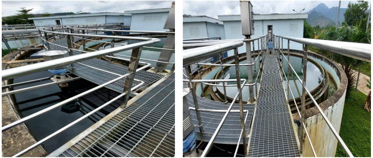
Hình 20: Cụm bể phản ứng và bể lắng hoá lý
