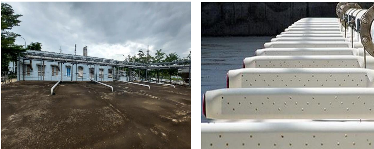
Hình 19: Bể điều hoà và Hệ thống phân phối khí bể điều hoà
