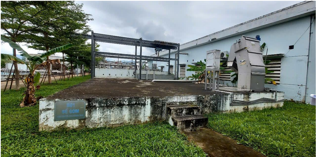
Hình 17: Bể gom và máy tách rác tự động
