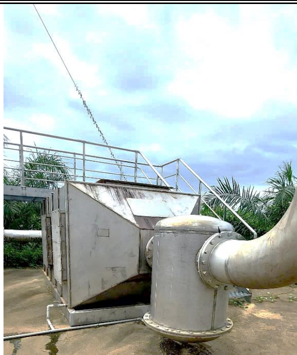
Tháp hấp phụ than hoạt tính
