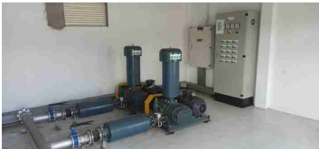
Hình 13. Máy thổi khí của hệ thống xử lý nước thải
