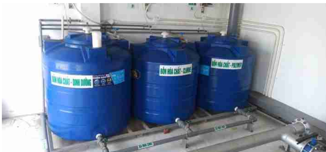
Hình 14. Bồn hóa chất của hệ thống xử lý nước thải
