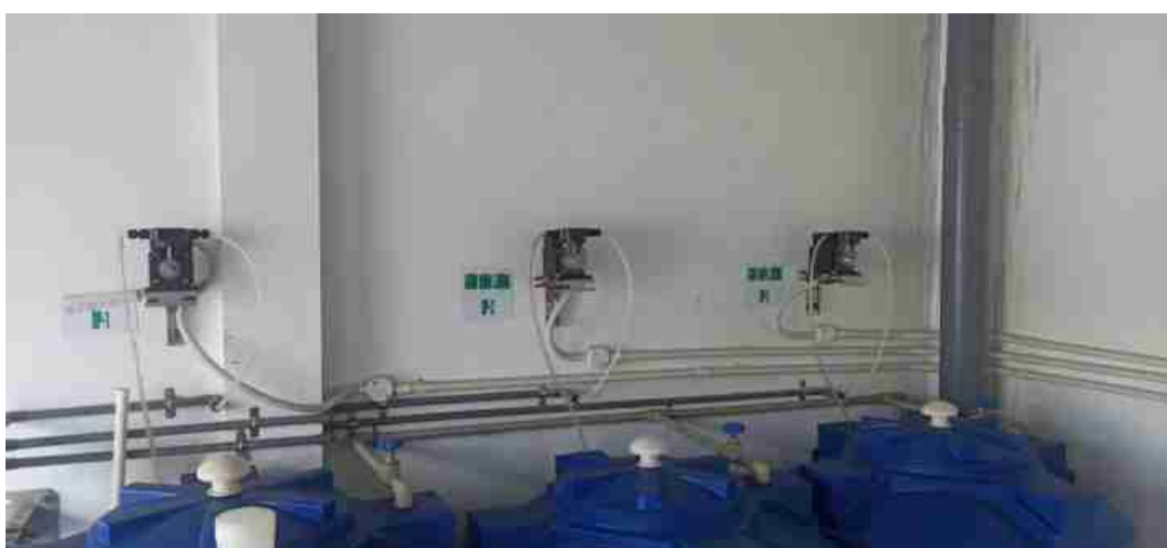
Hình 15. Bơm định lượng của hệ thống xử lý nước thải
