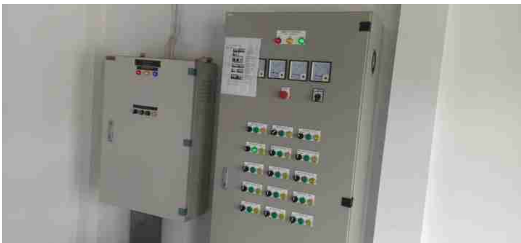
Hình 12. Tủ điện của hệ thống xử lý nước thải
