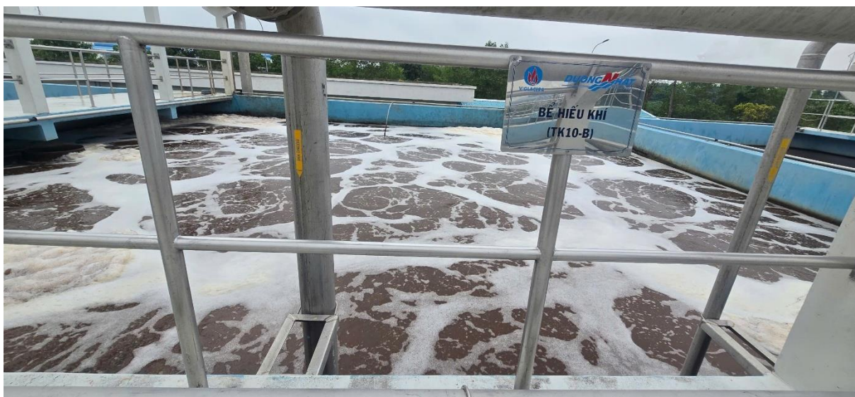
Hình 3.14: Bể hiếu khí
