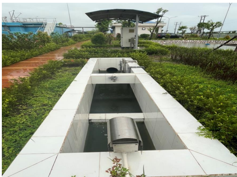
Hình 3.19: Hệ thống mương quan trắc tự động của trạm XLNTTT
