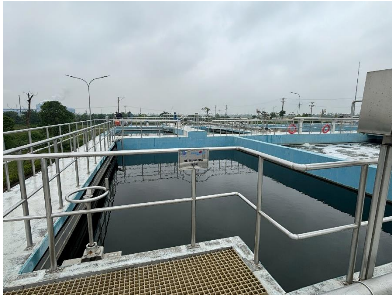
Hình 3.11: Bể điều hòa, Bể trung gian
