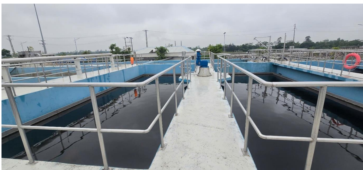
Hình 3.15: Bể lắng thứ cấp
