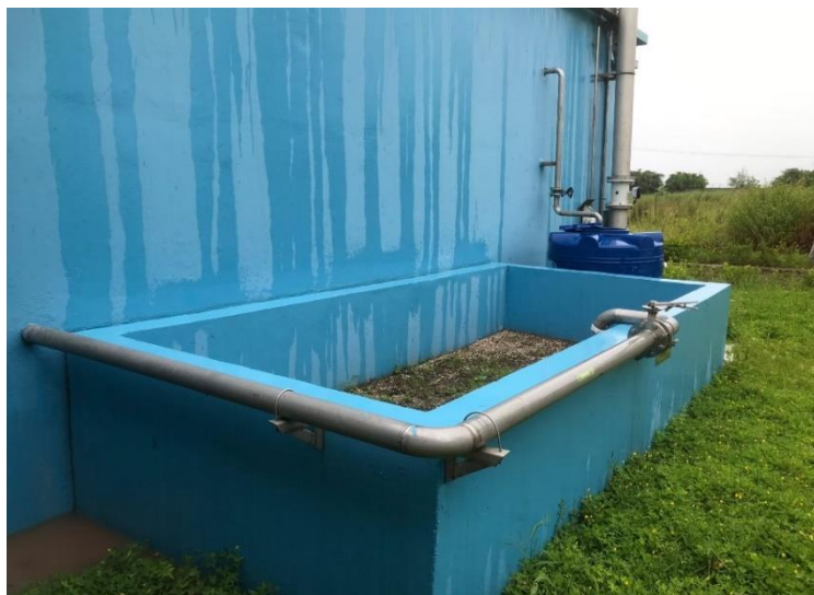
Hình 3.10: Bể chứa cát từ quá trình tách cát, dầu mỡ
