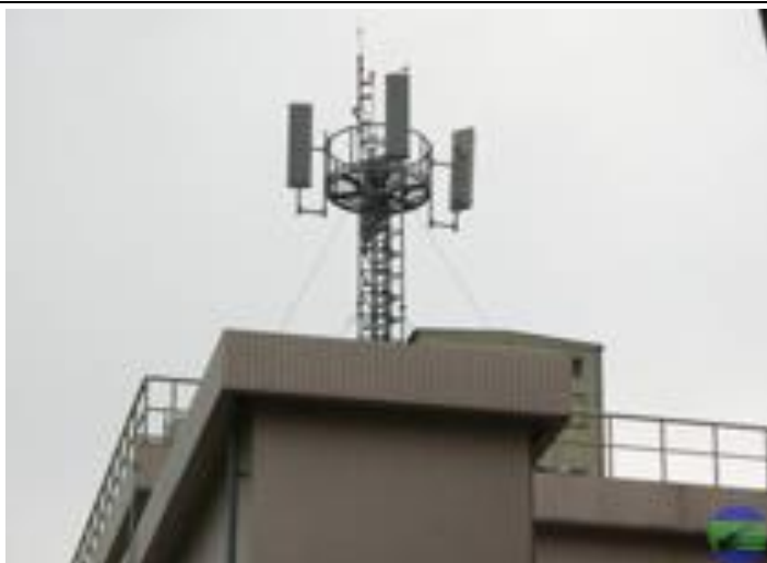
Hình 1.37. Hình ảnh Trạm gốc thu phát tại ga
