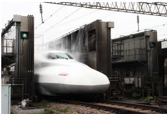
Hình 1.28. Nhà rửa tàu trong khu Depot
