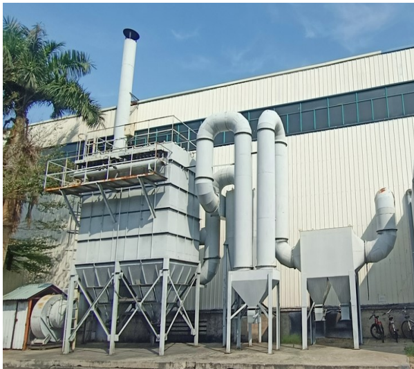
Hình 3.12. HTXL khí thải tại xưởng sản xuất ống tròn 1
