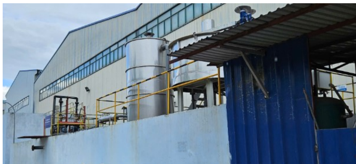
Hình 3.7. Hệ thống XLNT sản xuất hiện hữu công suất 80 m 3 /ngày.đêm Hệ thống tuần hoàn nước giải nhiệt:
