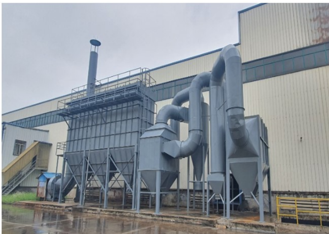
Hình 3.17. HTXLKT hiện hữu công suất 45.000 m³/giờ tại xưởng sản xuất ống thẳng
