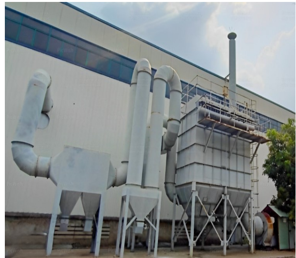
Hình 3.13. Hệ thống xử lý khí thải tại xưởng sản xuất ống tròn 2
