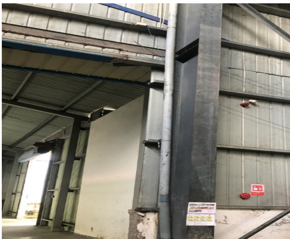
Hình 3.26. Hệ thống thu gom nước mưa trên mái của nhà máy hiện hữu
