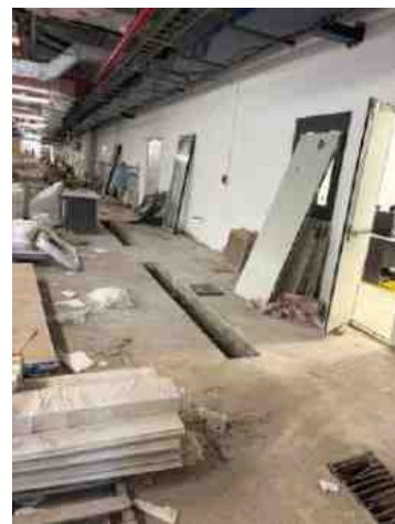
Thoát nước mưa tầng hầm
