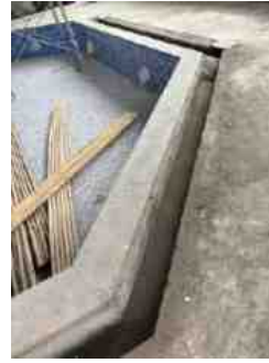
Rãnh thu nước chảy tràn bể bơi về bể cân bằng
