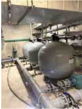
Bình lọc nước bể bơi
