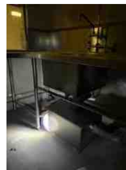
Bể tách mỡ inox đặt dưới mỗi chậu rửa nhà bếp
