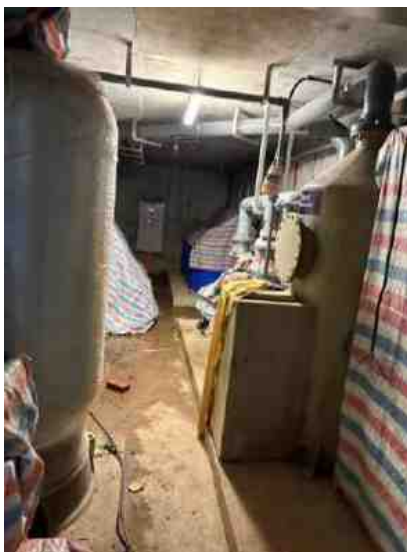
Hình 3-12: Tháp khử mùi tại dự án
