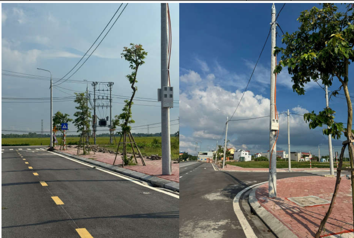
Hình ảnh hệ thống điện sinh hoạt + chiếu sáng công cộng đã lắp đặt
