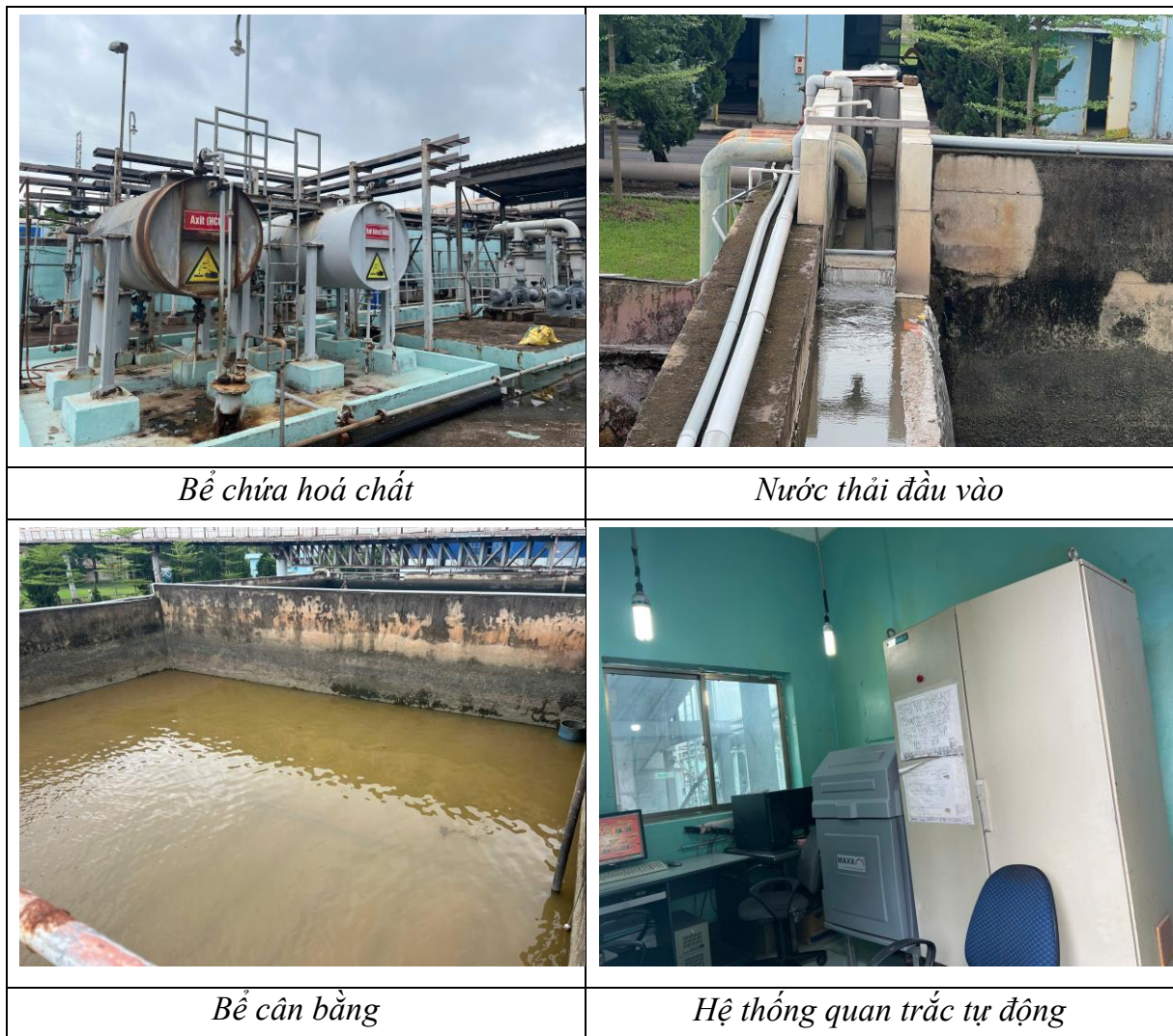
Hình 3. 8. Một số hình ảnh hệ thống xử lý nước thải công suất 330 m 3 /ngày đêm
