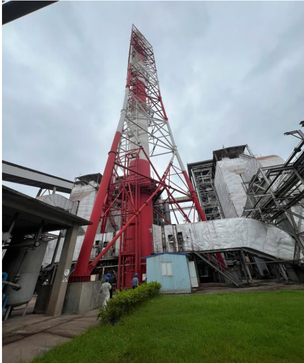
Hệ thống xử lý khí thải
