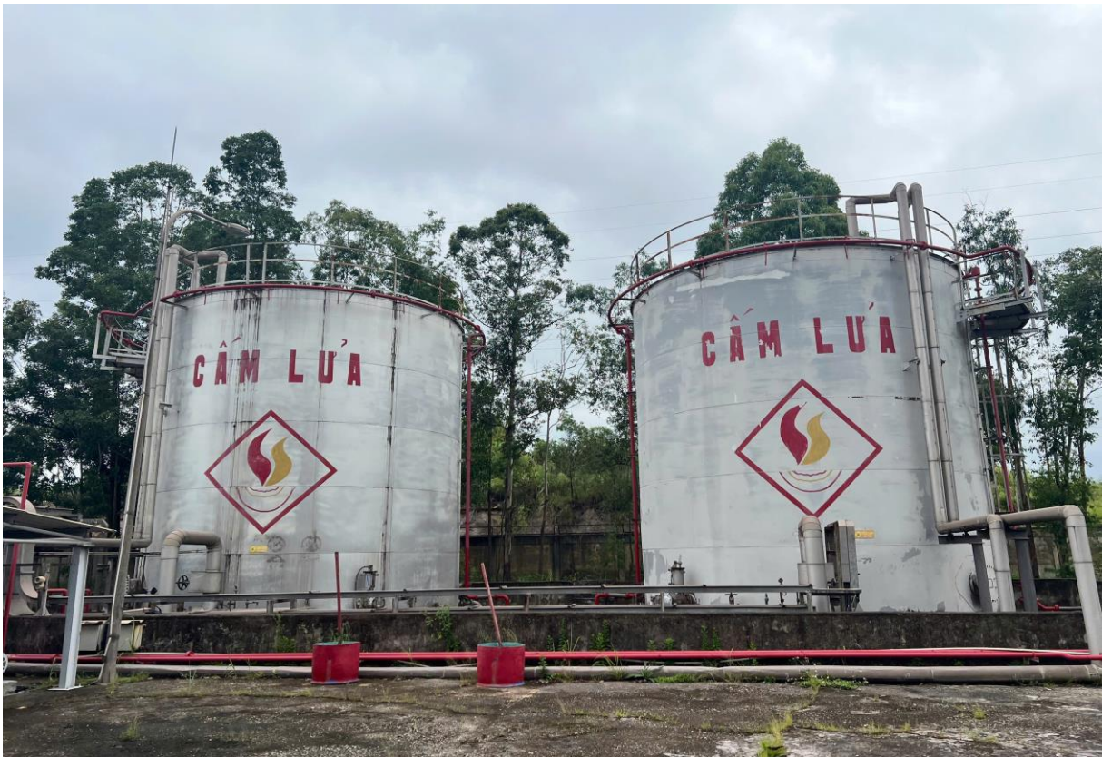
Hình 1. 5. Bể chứa dầu để khởi động lò hơi của nhà máy
