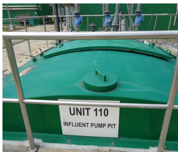
Bể gom nước thải của Nhà máy
