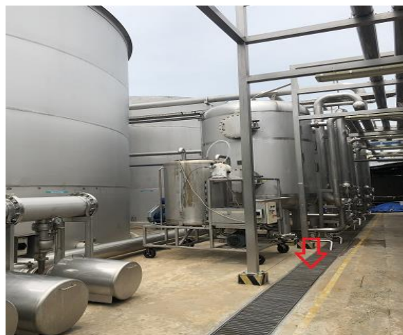
Hệ thống thu gom nước thải ngoài nhà
