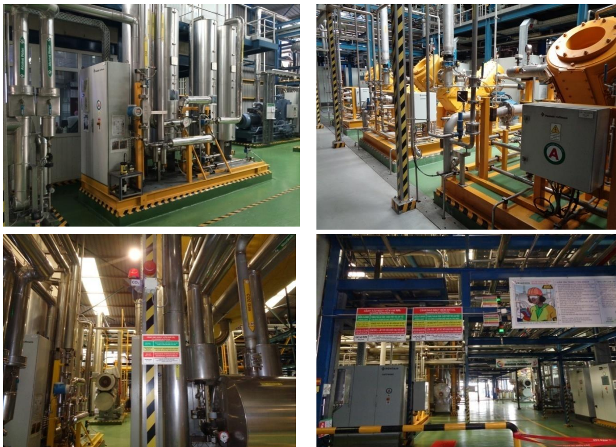
Hình 3-7: Hình ảnh hệ thống thu hồi CO 2 của Nhà máy
