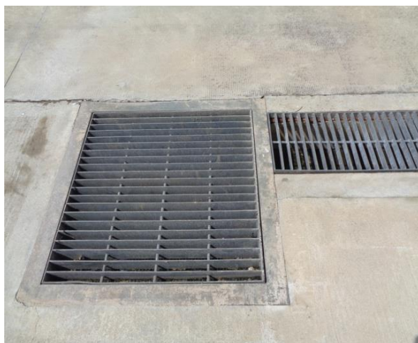
Hố thu gom nước thải ngoài nhà
