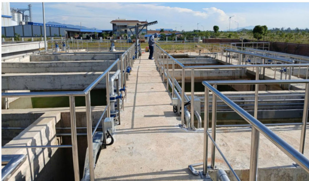
Hình 3. 11. Hệ thống xử lý nước thải công suất 1.200 m 3 /ngày đã xây dựng hoàn thiện tại KCN Hòa Hội
