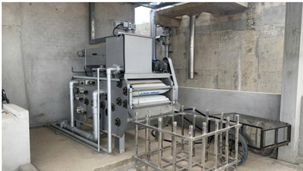
Hình 3. 12. Máy ép bùn băng tải tại trạm XLNT tập trung
