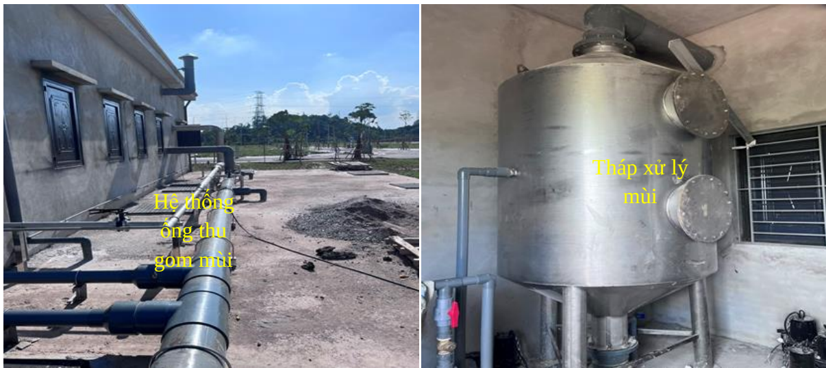
Hình 3. 12. Hệ thống thu gom và xử lý mùi tại khu vực Trạm xử lý nước thải
