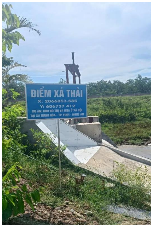
Hình 3.5. Hình ảnh điểm xả nước thải của cơ sở
