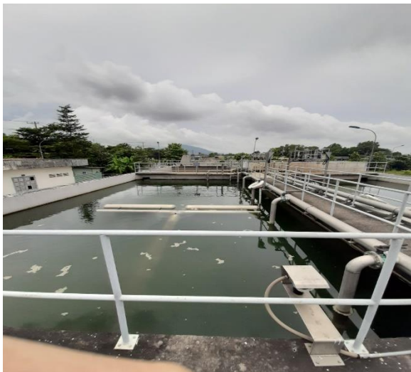
Bể SBR cải tiến
