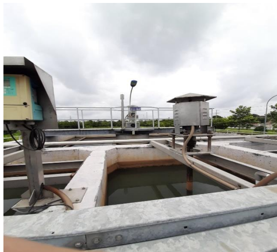
Bể lắng hoá lý
