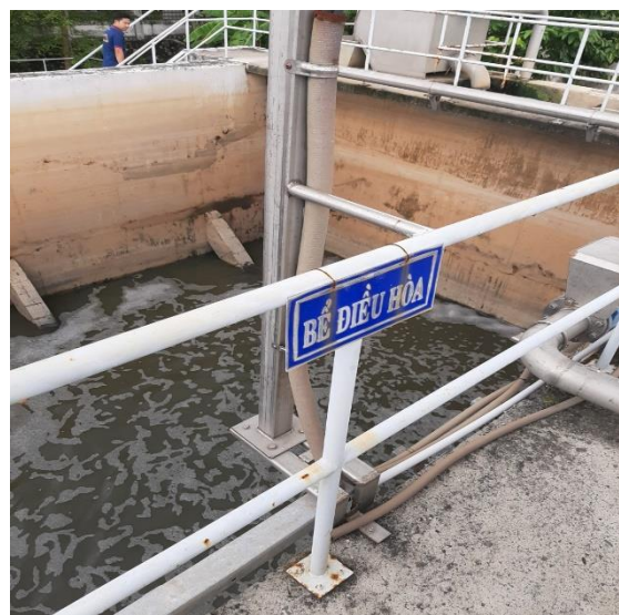
Bể điều hoà
